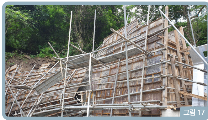
[그림 17] 붕괴사고 현장 비계발판 설치 상태
