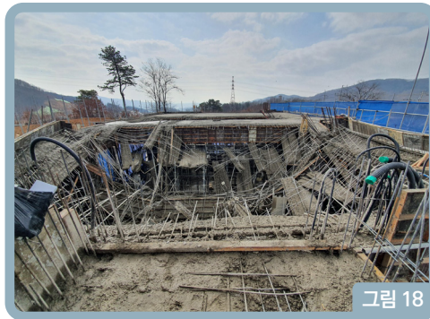
[그림 18] 거푸집동바리 붕괴사고 현장 전경
